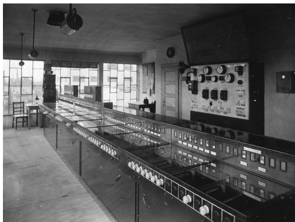
Až do roku 1987 sloužil na stavědle 1 na severním zhlaví stavební přístroj elektrodynamického zabezpečovacího zařízení značky Elektrotechna z roku 1934. Zdroj: Muzeum Komenského v Přerově.
